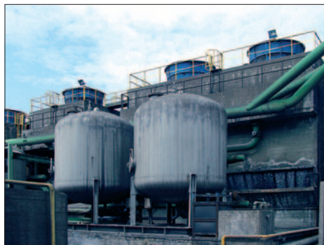
Las torres de refrigeración deben ser vigiladas exhaustivamente. LVDT.
